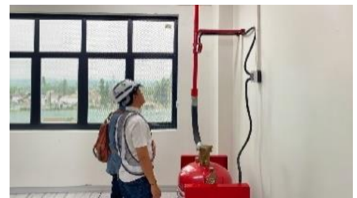
FM200 Fire Suppression System PT. WIKI Gedung Tbk Stasiun Kereta Cepat KCIC Padalarang
